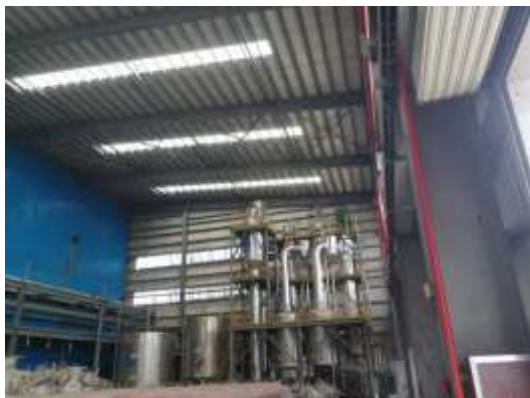
现有工程三效蒸发装置
