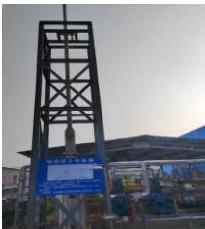
现有工程浆叶干燥废气处理装置
