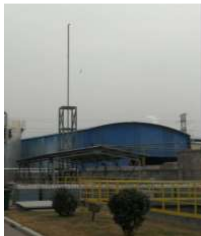
甲醛罐区废气处理装置
