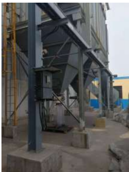
现有工程投料废气处理装置
