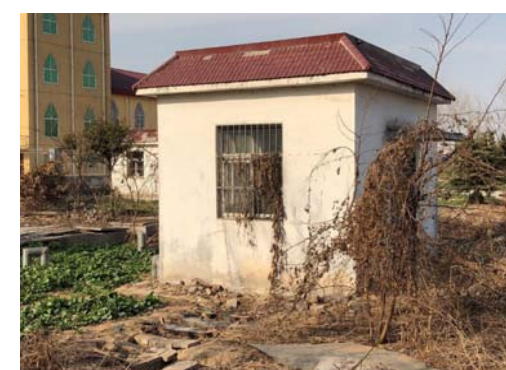
祥和社区污水处理站
