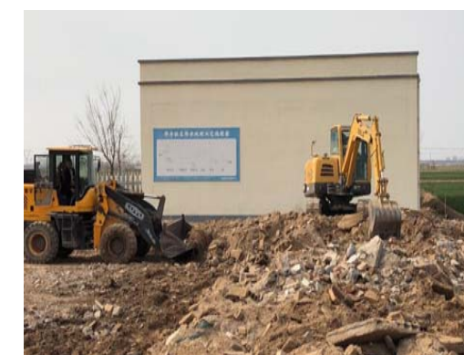
华丰社区污水处理站
