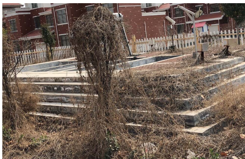
原庄社区污水处理站
