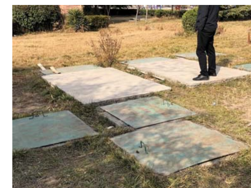
富康社区污水处理站
